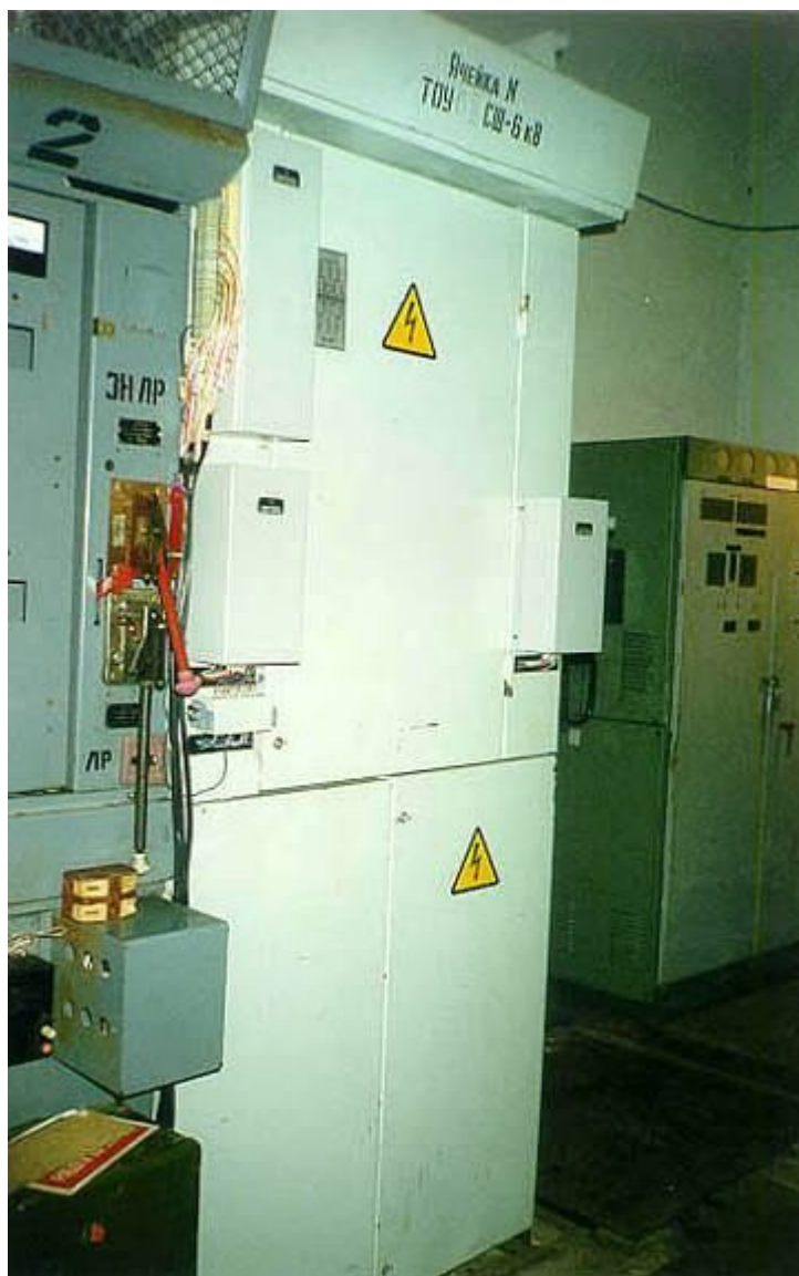
Рисунок 14 Силовой шкаф ТУУ
